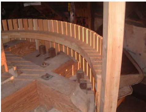
Afscherming rondom een onderbonkelaar van binnenuit gezien.
