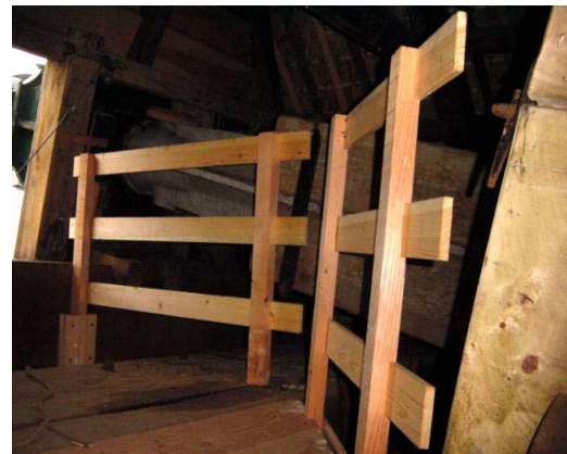
Afscherming van draaiende delen op de kapzolder. Wel demontabel aanbrengen.
