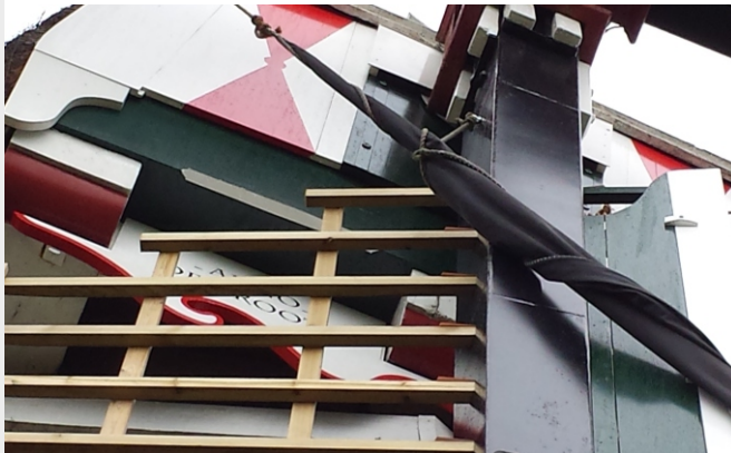
Het gevluht is in 2015 vervangen
