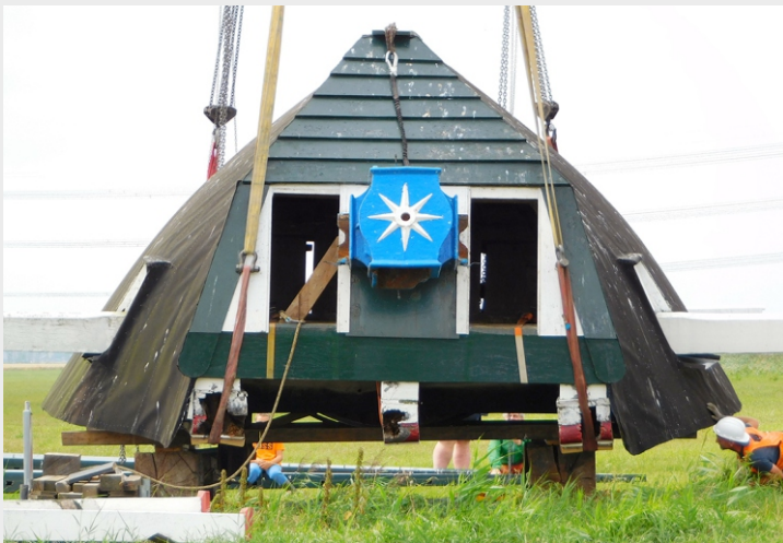
Gedemonteerde kap met aangetaste voeghouten en tempelbalk
