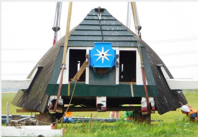
Gedemonteerde kap met aangetaste voeghouten en tempelbalk
